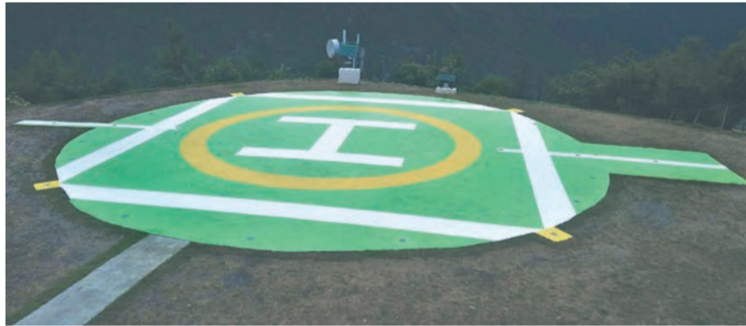
आपत्कालीन अवस्थामा राति पनि अवतरण गर्न मिल्ने गरी नेपाली सेनाले सदरमुकाम धुन्चेमा निर्माण गरेको आधुनिक किसिमको हेलिप्याड ।
