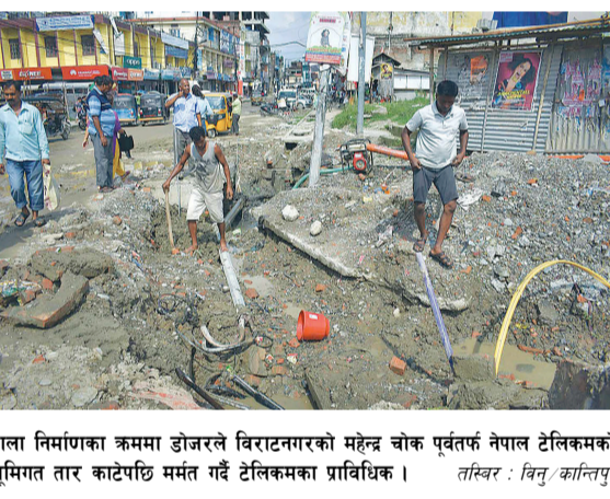
नाला निर्माणका क्रममा डोजरले विराटनगरको महेन्द्र चोक पूर्वतर्फ नेपाल टेलिकमको भूमिगत तार काटेपछि मर्मत गर्दै टेलिकमका प्राविधिक।
