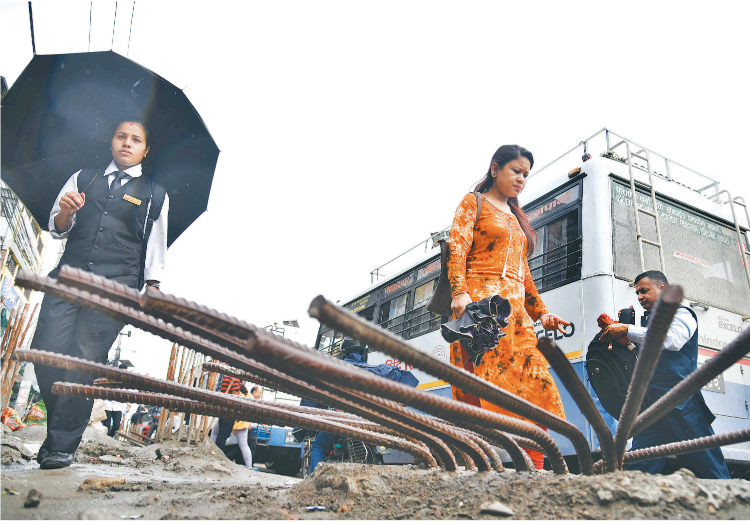
काठमाडौं नयाँबानेश्वर चोकमा आएको पुल निर्माण गर्न गाडिएका फलामे छड छुट्टै सर्वसाधारण। अल्पत्र छडका कारण दुर्घटनाको जोखिम बढेको छ।
