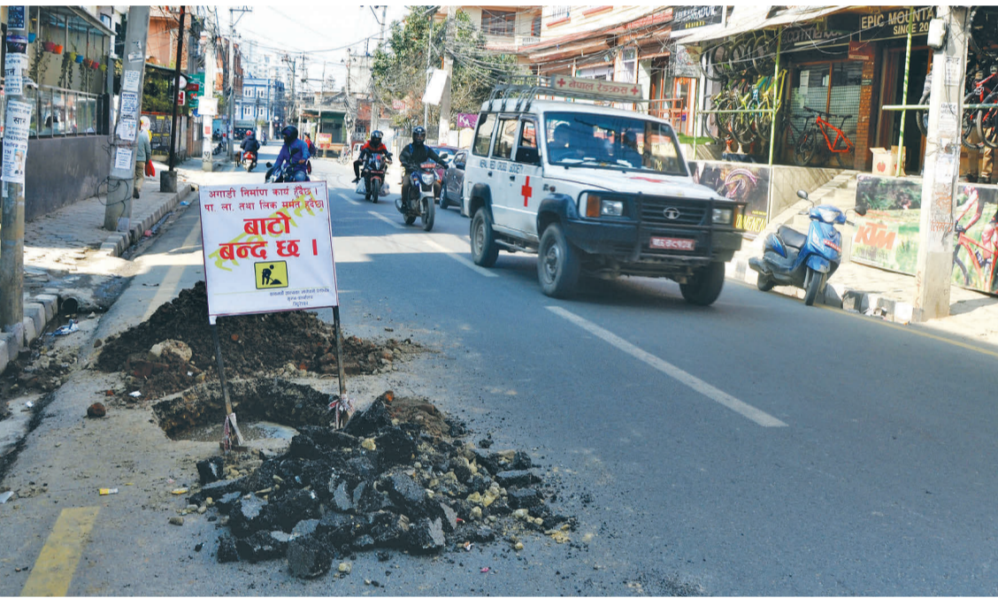
डिभिजन सडक कार्यालय ललितपुरले कालोपत्र गरेको सातादिन नबित्दै काठमाडौँ उपत्यका खानेपानी लिमिटेडले भम्सीखेलमा खनेको सडक। तस्वीर : प्रधान/कान्तिपुर
