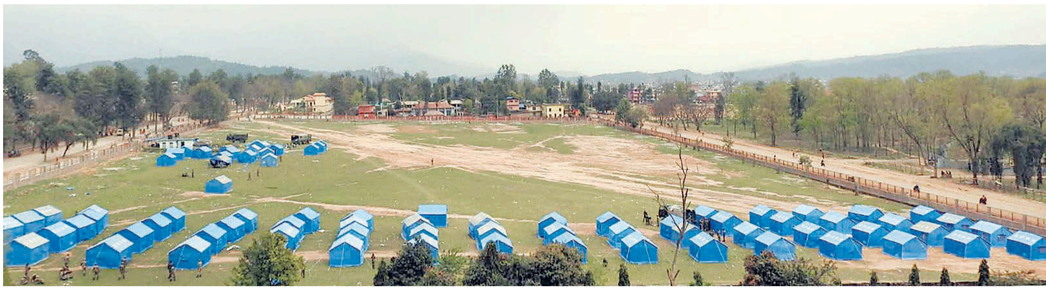
सुर्खेतको धीरेन्द्रनगरस्थित खुलामञ्चमा निर्माणाधीन क्वारेन्टाइन। संक्रमित मुलुकबाट आएकाहरूलाई राख्न नेपाली सेनाले यहाँ आइतबार चार सय शय्याको क्वारेन्टाइन बनाउन थालेको हो।
