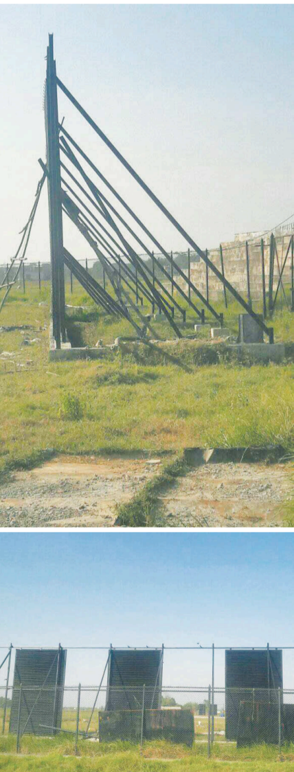
बैजनाथपुर क्रिकेट मैदानमा निर्माण गरिएको क्रिकेट पिच र साइड स्क्रिन । अब त्यहाँ प्रदेश सरकारको २ करोडको लागतमा पेभेलियन निर्माण गर्ने तयारी गरिएको छ । तस्विर : विनोद/कान्तिपुर
