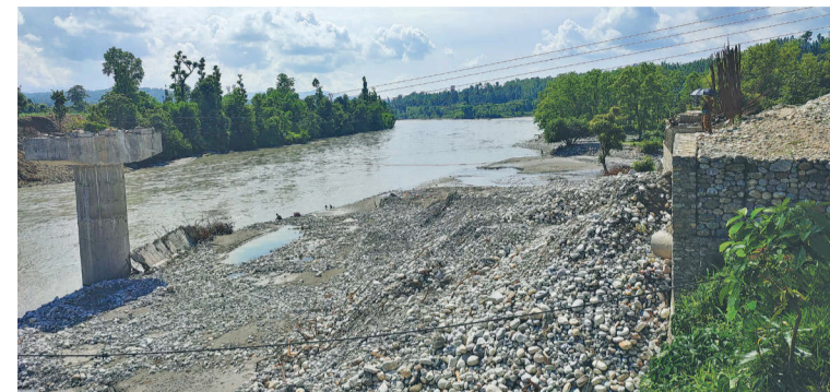
सुर्खेतको भेरीगंगाको जहरेस्थित निर्माणाधीन मोटरबल पुलको पिलर भत्काइएको अवस्थामा।
