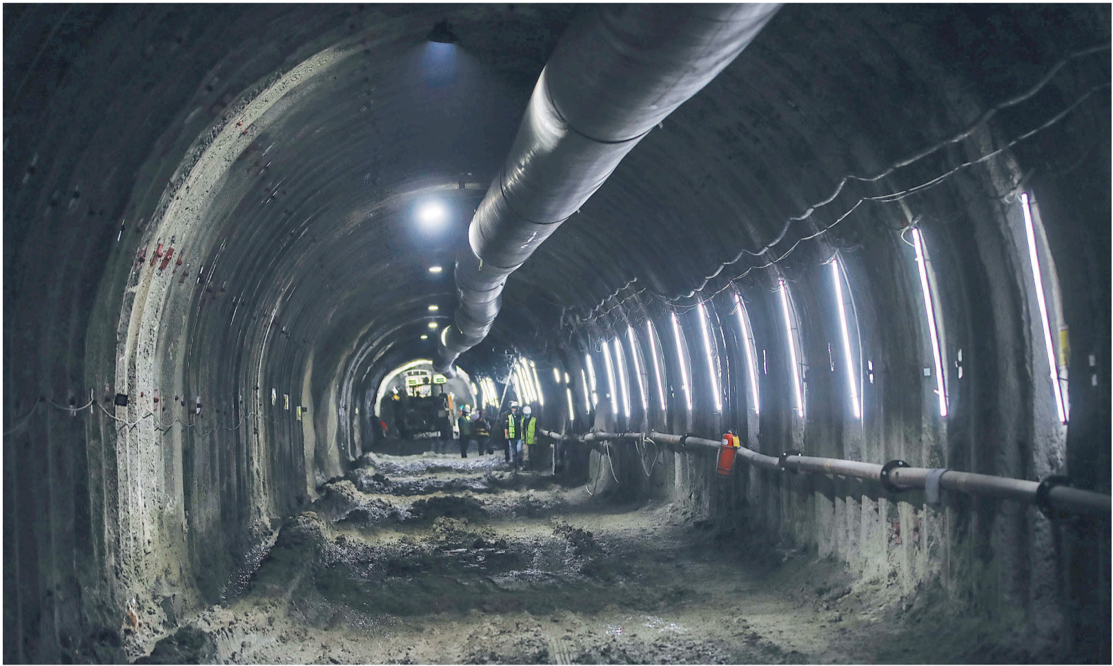
निर्माणधीन नागढुंगा-सिस्नेखोला सुरुडमार्ग। कोरोना संक्रमणको महामारीले पूर्वाधार विकास आयोजनाहरू प्रभावित भए पनि यो सुरुडमार्गको निर्माण रोकिएन।
