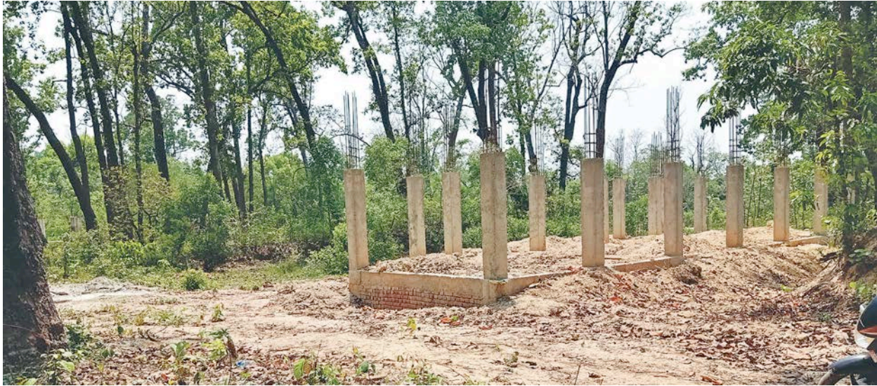
चुरेसँगै जोडिएको लालभाडी मोहना संरक्षित वनअन्तर्गत गडबिजुला सामुदायिक वनमा अवैध रूपमा निर्माणाधीन संरचना ।
