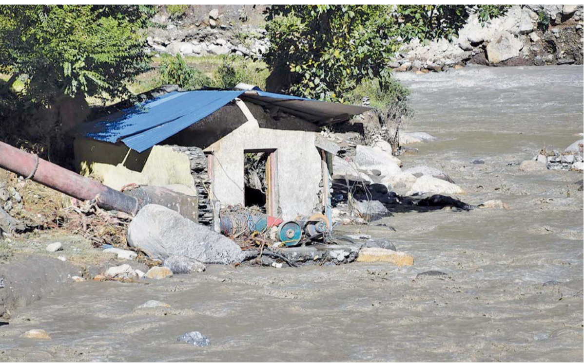
माथि सिन्धुपाल्चोकको भोटेकोसी नदी किनारको बाढीले क्षतिग्रस्त लाफिडबुङ जलविद्युत् आयोजना।
