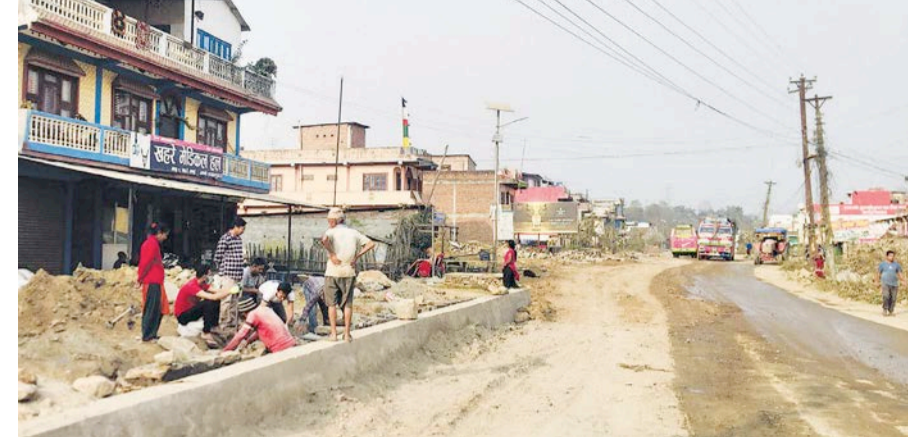
बेसीसहर-डुम्रे सडकअन्तर्गत तनहुँको खरे क्षेत्रमा डबल लेनको सडकका लागि नाला निर्माण गरिँदै। तस्बिर : आश/कान्तिपुर
