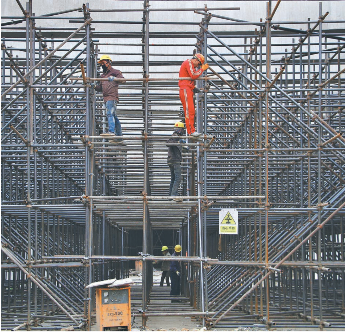
राजधानीको कलंक्रीमा बनाउँदै गरिएको सुरङ (अन्डरपास) मा काम गर्दै मजदुरहरू । आगामी पाँच महिनामा सुरङको निर्माण कार्य सम्पन्न गर्ने गरी काम भइरहेको छ । तस्वीर : विजु महजन
