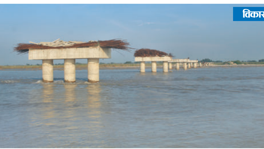
भ्रमणको हुलाकी राजमार्गअन्तर्गत कन्काई नदीमा निर्माणाधीन पुल । पप्पु कन्स्ट्रक्सनले ४ वर्षमा पूरा गर्नुपर्नेमा ७ वर्ष पुग्दा पनि आधा काम भएको छैन । निर्धारित समयमा पुल नबन्दा सर्वसाधारण जोखिम मोलेरै काठको डुंगामा नदी वारपार गर्न बाध्य छन् ।
